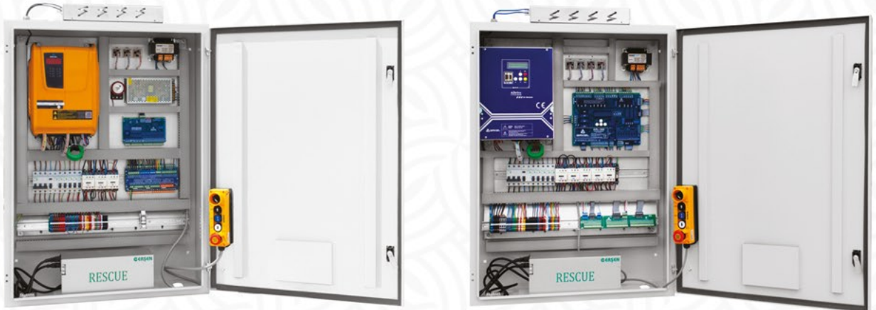
Dişlisiz, Dişlili - Makine Dairesi Sistemi (MR) Kontrol Paneli
